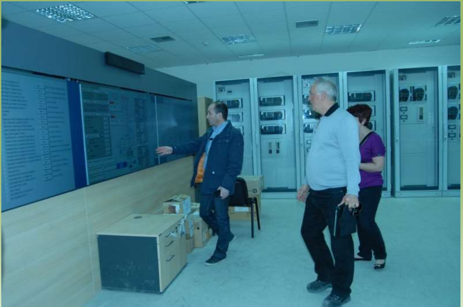
Ιλαρίωνας Control Room
