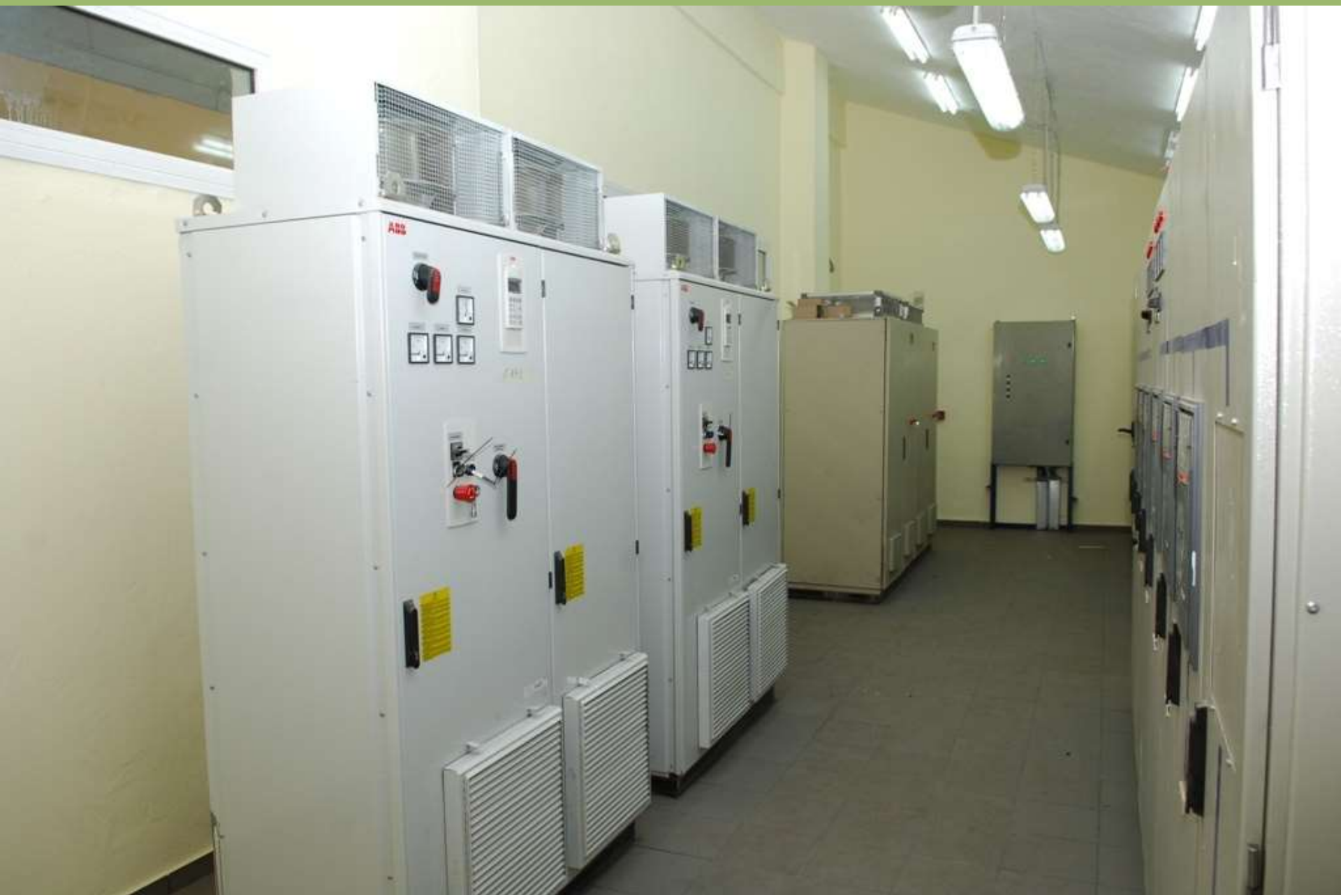
Control Room Τηλεθέρμανσης
